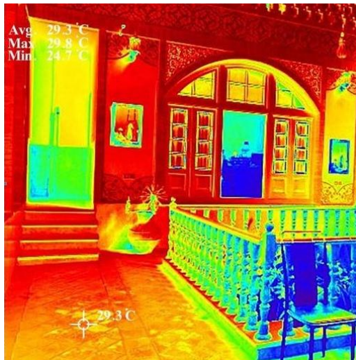
شکل ۳. تصویربرداری شده با دوربین حرارتی از بنای خواجه خضر در یزد (مأخذ: نتایج تحقیق)
