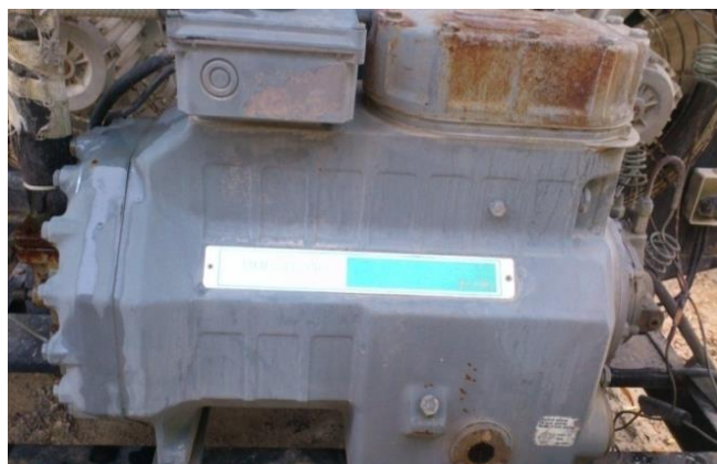
شکل ۱۵) برطرف شدن یخ زدگی کمپرسور بعد از اقدام اصلاحی
