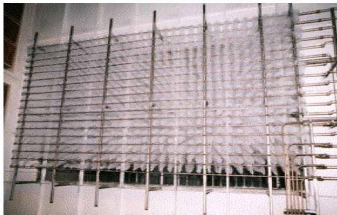
شکل ۲. چیدمان نازل ها در داخل مجرای هوای ورودی توربین گاز GE7-EA
