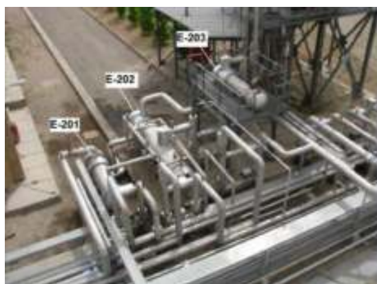
شکل ۳: نمایی از مبدل‌های موجود در نیروگاه خورشیدی شیراز [۱۳]
