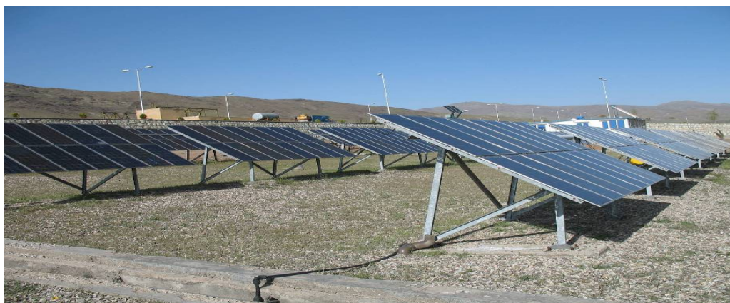
شکل ۴: نمایی از سلولهای فتوولتائیک نصب شده در سایت طالقان
