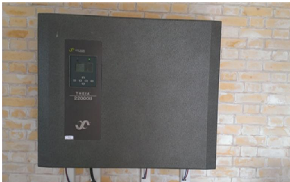
شکل ۶) اینورتر سیستم مانیتورینگ نیروگاه دانشگاه یزد
